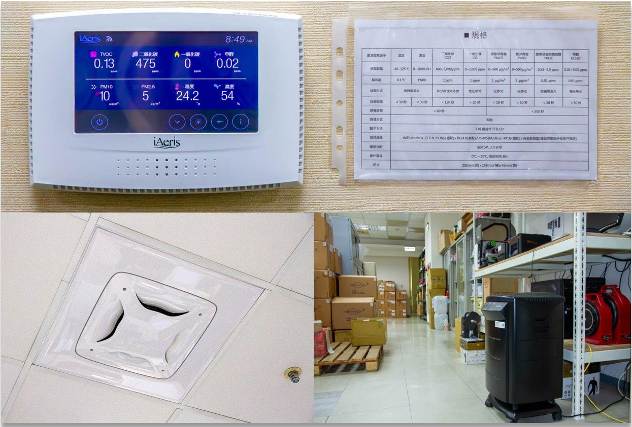
▼【圖 5.5-1】辦公區域設置空氣清淨機及空氣品質監測儀，並完成改善換氣抽風系統。
