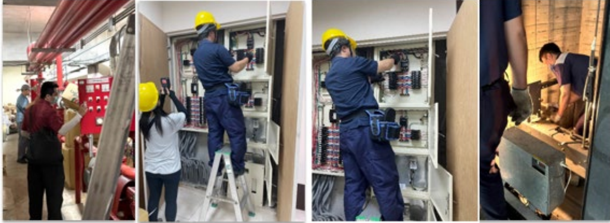
▼【圖 5.5-4】設備安全自主檢查 (消防定檢、配電盤定期維護、電梯定期維護)
